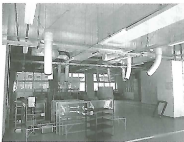
機械科実習室の空調設備
