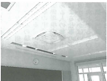
ホームルーム教室の空調設備
